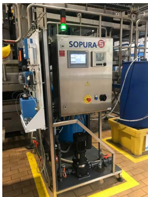
Hình 6. Hệ thống Brominator - Sopura
